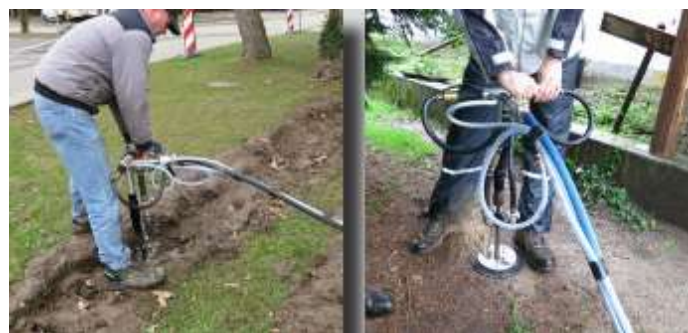
Intervention sur dégâts suite passage d'engin
